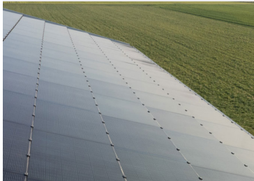
Photovoltaikmodule auf dem Dach. ©Megasol
