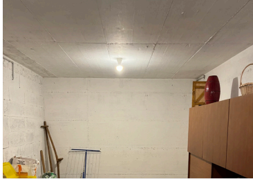
Plafond du sous-sol à isoler
