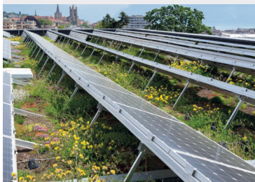
Type de panneaux photovoltaïques conseillés et végétalisation de la toiture. ©Ville de Lausanne, photographie: Benoît Renevey
