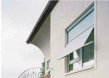
Stores à projections extérieurs pour éviter le pont thermique. ©Rapin Saiz architectes, photographie: Joël Tettamanti
