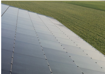
Panneaux solaires en toiture. ©Megasol
