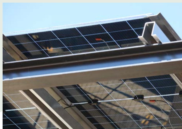
Monitoring de la performance photovoltaïque sur le pavillon STEP © Alejandro Paz (EPFL PL-MTI)
